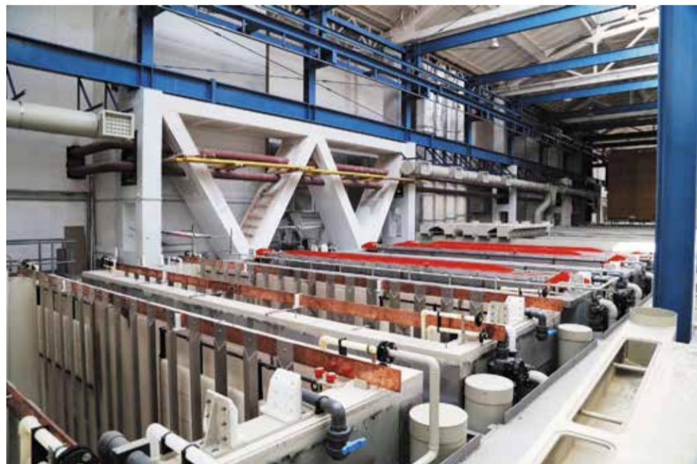
Автоматизированная линия химфрезерования и анодирования цеха 27 позволит обеспечить качественное покрытие крупногабаритных деталей
